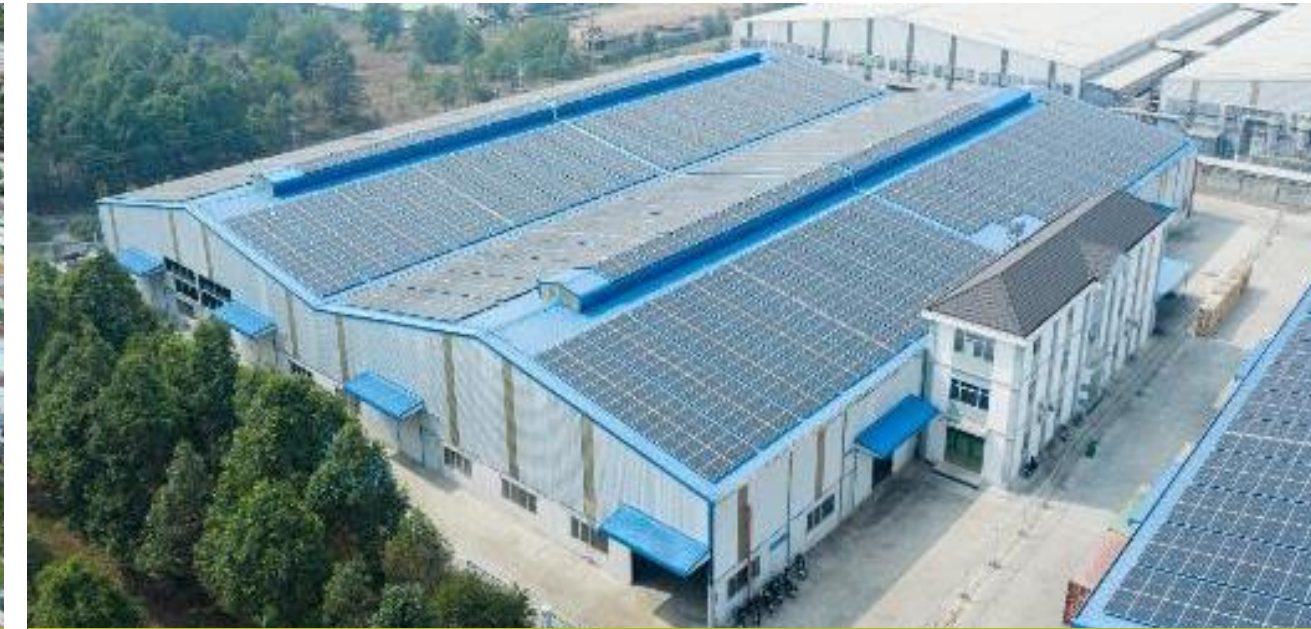
Ngan Hoang Phat, My Phuoc | 2,104 kWp
