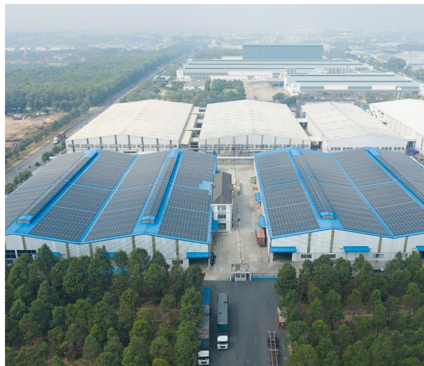
Điện mặt trời trên mái nhà
