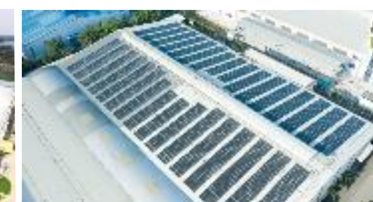
Mekong Bến Tre | 768.96kWp
