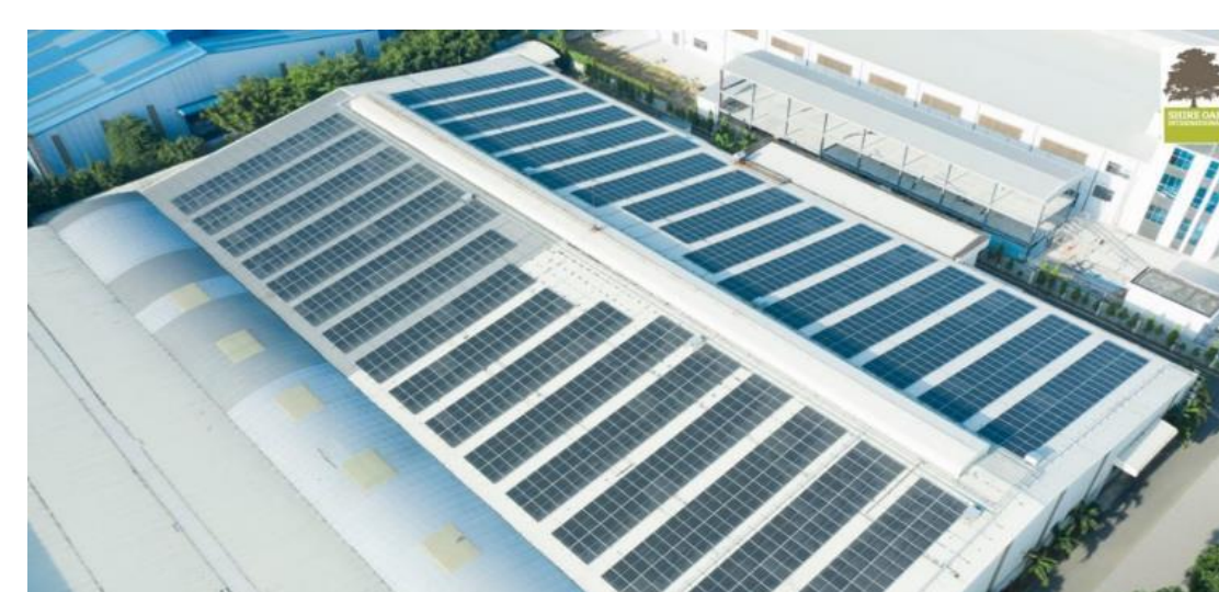
Mekong Bến Tre | 769 kWp
