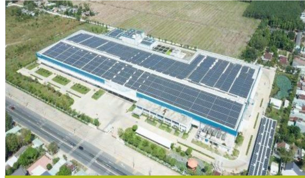
Tanifood, Tây Ninh | 5,125 kWp
